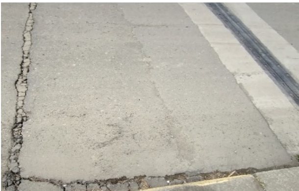
(c) Juntas de dilatación mal colocadas.
