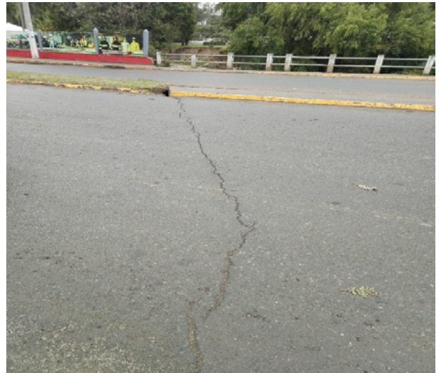
(a) Falta de juntas de dilatación
