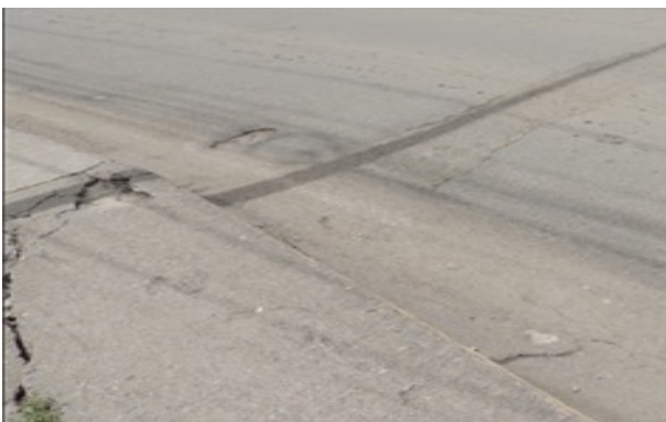
(d) Falta de juntas de dilatación.
