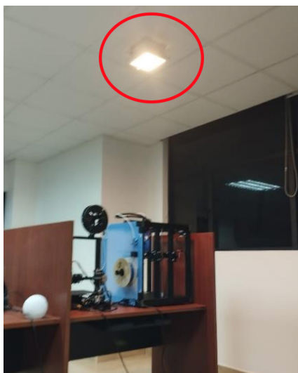
Gráfico 5. Luminaria inteligente instalada. Fuente: los autores, Ecuador, 2023.
