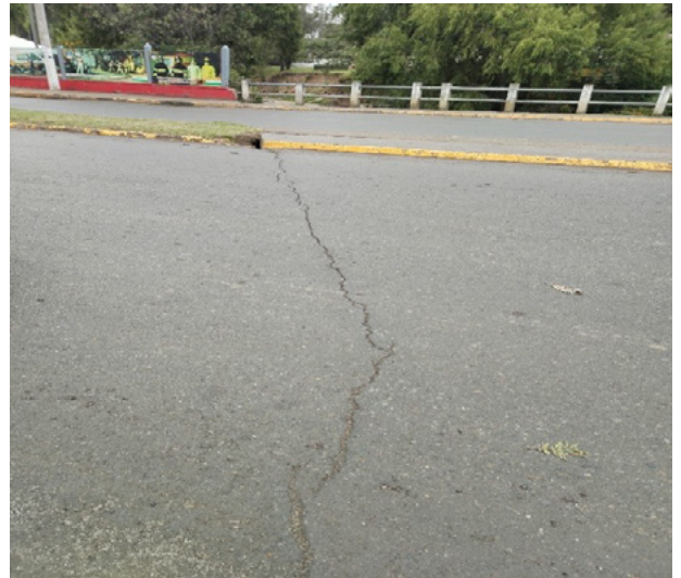
(a) Falta de juntas de dilatación
