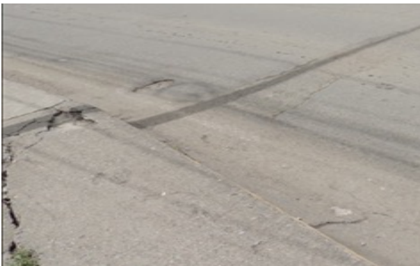
(d) Falta de juntas de dilatación.
