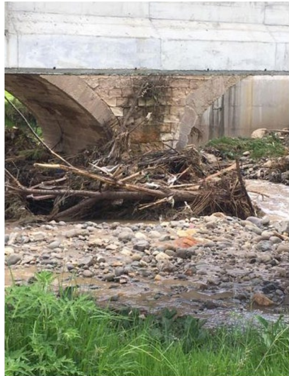
FIG. 12. Materiales sólidos debido a crecientes
