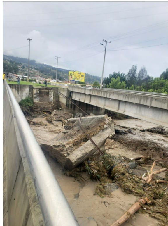
FIG. 13. Puente colapsado después de la crecida del 20 de abril de 2022
